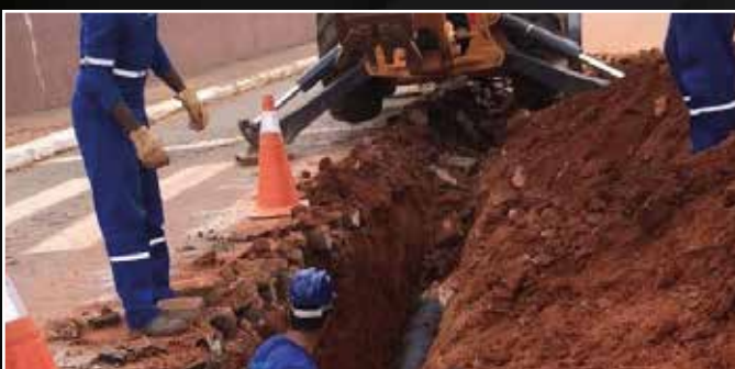
Implantação de adutora de água tratada para o Loteamento Horizontes da Serra em Ubá - MG
