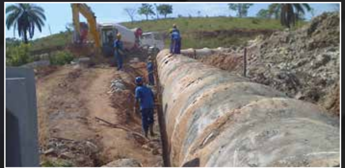
Implantação da rede de drenagem com tubo de concreto JR DN1500mm no Loteamento Portal Do Sol - Bosque da Lagoa em Contagem - MG
