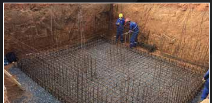
Bloco de ancoragem para curva de adutora de água bruta de FoFo DN500mm em Ubá - MG
