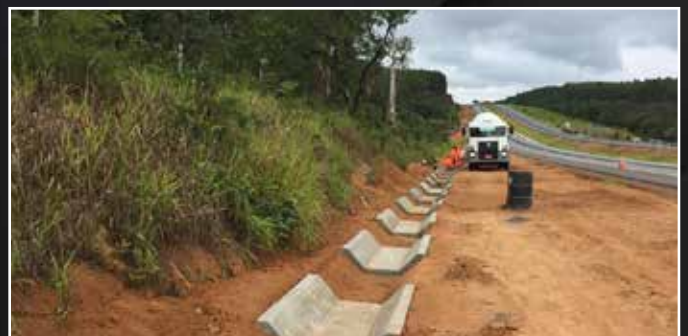
Implantação de sarjeta trapezoidal padrão DNIT na BR - 040 em João Pinheiro - MG
