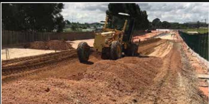
Base de bica corrida da Avenida Maria da Glória em Contagem - MG.
