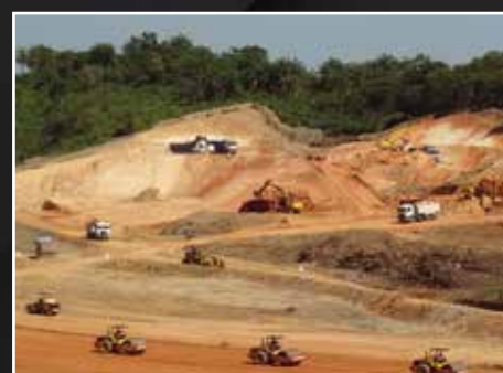
Terraplenagem para implantação da nova fábrica da Orthocrin em Santa Luzia - MG
