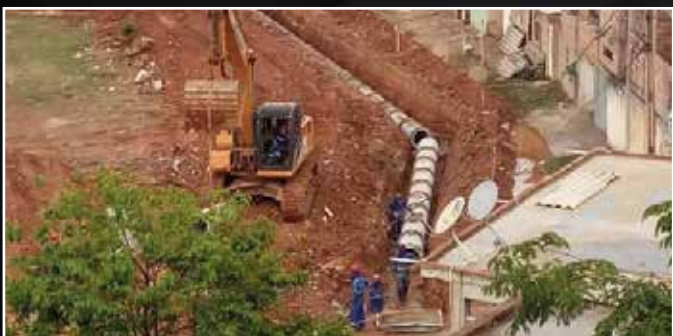
Implantação da rede de drenagem com tubo de concreto JR DN800mm em Sabará - MG
