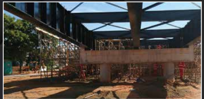
Implantação das transversinas que ligam as vigas da ponte, estrutura com peso total superior a 100.000 quilos.
