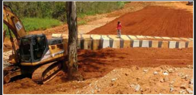
Implantação de galeria celular na travessia da Avenida Hítalo Ross em Araxá - MG
