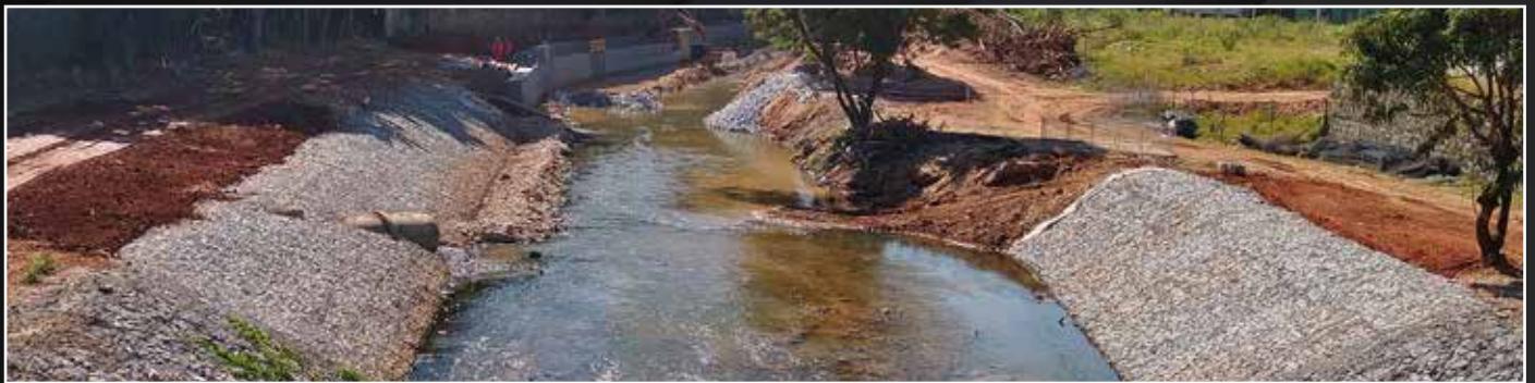
Execução de gabião tipo colchão revestindo as margens do Ribeirão Pampulha em Belo Horizonte - MG (Obra concluída em 2021).
