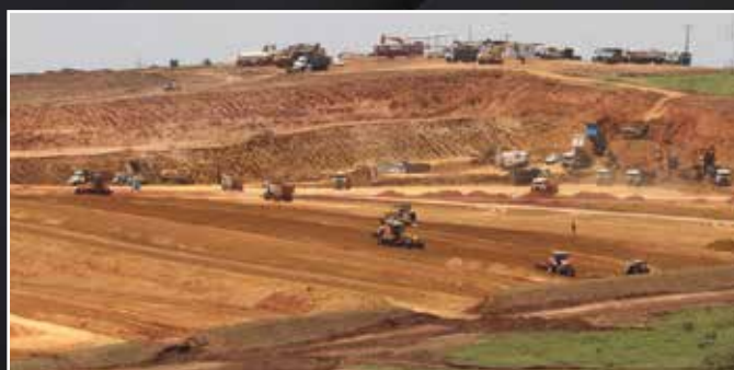
Área de escavação, carga e transporte de material no platô do Fashion City
