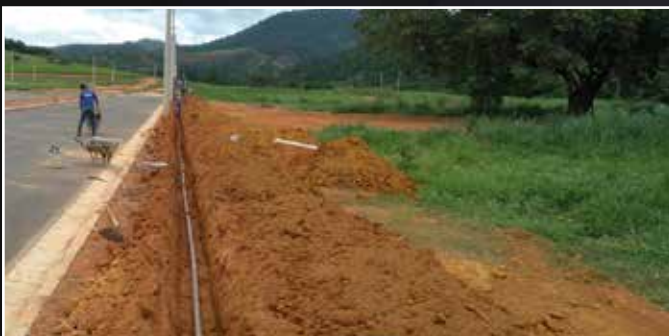
Implantação da rede de distribuição de água potável no loteamento Gameleira em Belo Oriente - MG
