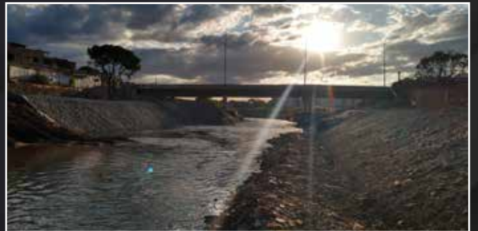
Gabião protegendo os pilares da Ponte São Bernardo que liga o Bairro Vila Aeroporto ao Bairro São Bernardo na Pampulha em Belo Horizonte.
